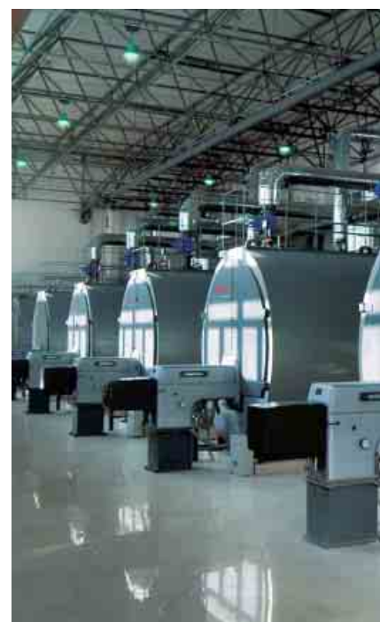
In der Heizzentrale der Wohnanlage „Zi Wei Garden“ wurden sieben Vitomax 200 mit einer Leistung von je 15 MW installiert.
